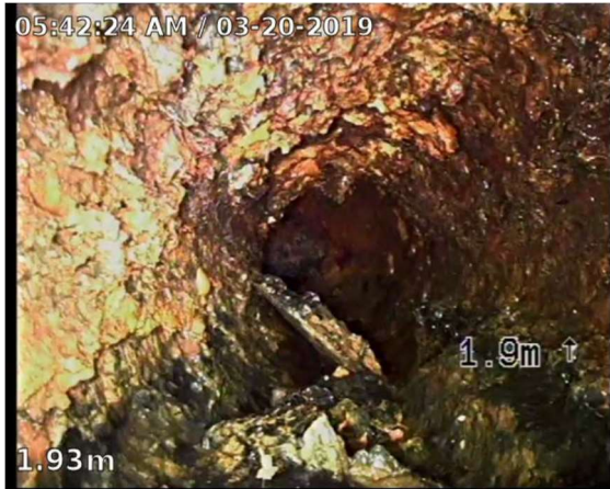
Grenledning från diskbänk
