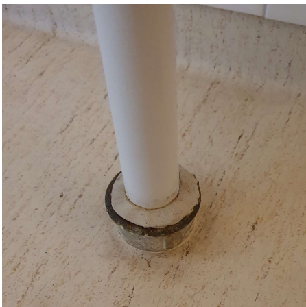
Rostigt avloppsrör i toalett
