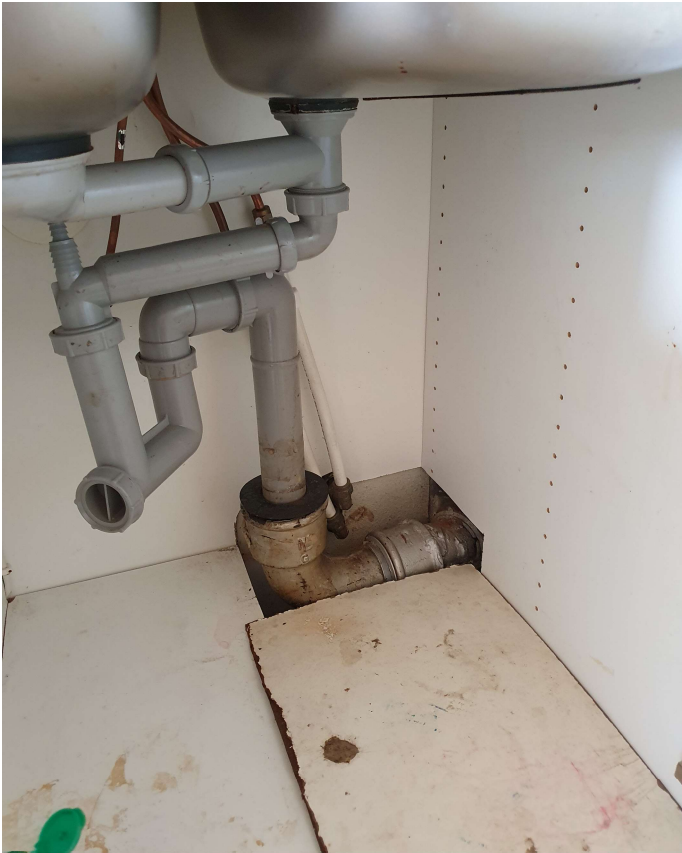
Diskbänkskåp med otät bottenanslutning och gammalt avloppsrör med g-rings tätning
