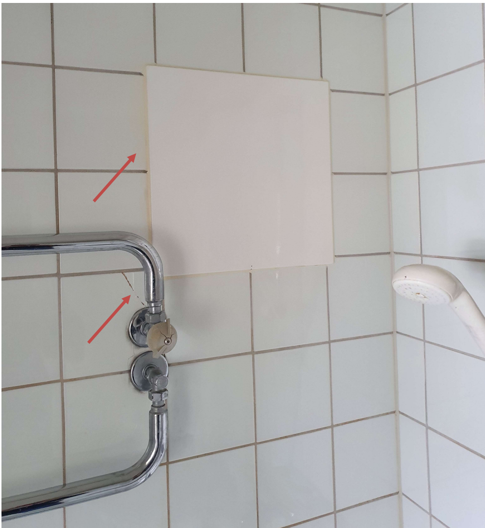
Sprucket kakel, rörgenomföring och bristfällig lagning av vägg i bad/duschplats i våtzon1.
