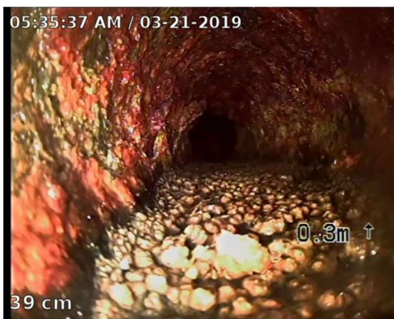
Grenledning från tvättställ
