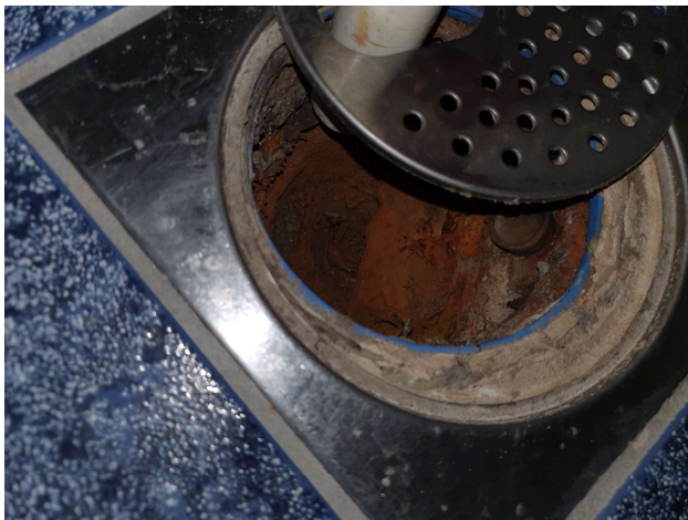
Gammal rostig golvbrunn i badrum
