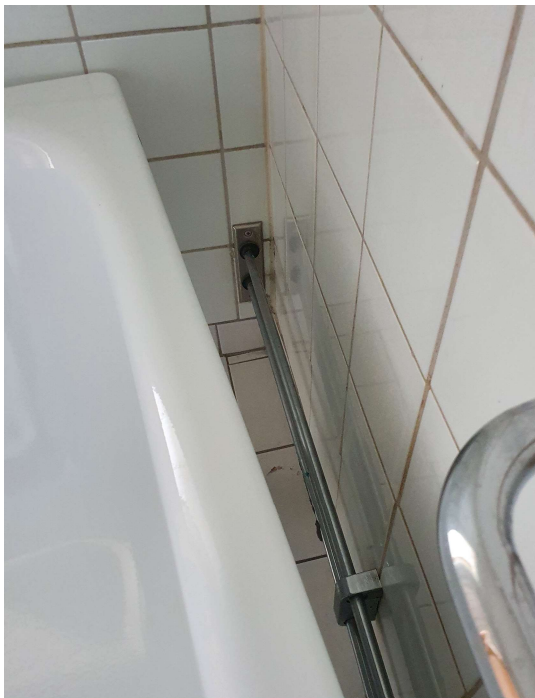
Rör genomföringar nedtill i våtzon 1
